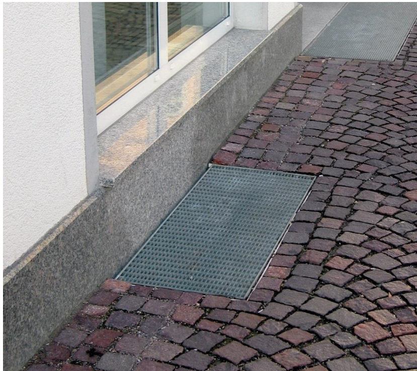
ABBILDUNG 19: KELLERLICHTSCHACHT (FOTO: MEA WATER MANAGEMENT GMBH)
